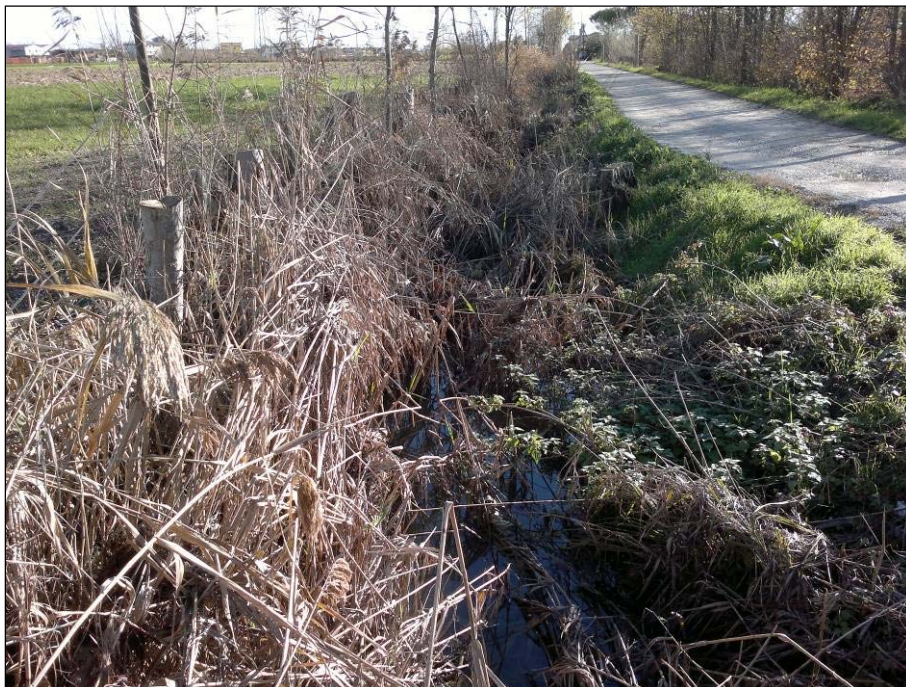
Figura 120. Affossatura di via Lago di Candia e relativo stato di manutenzione
