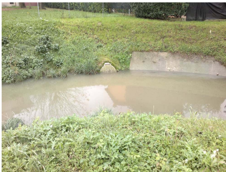
Figura 13. Punto di recapito nello scolo Comuna (con porta a vento)
