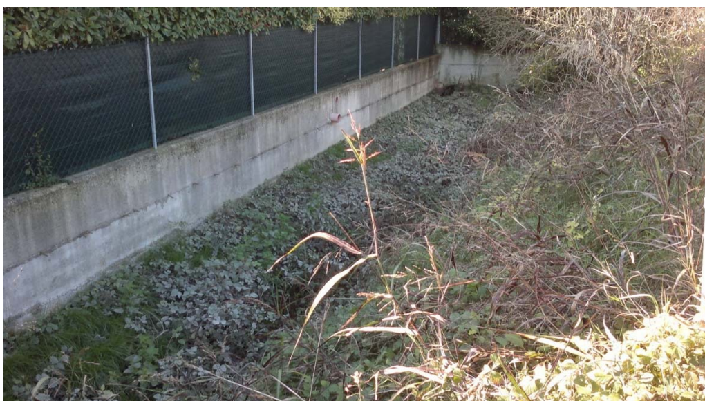
Figura 32. Stato manutenzione fosso a monte della ferrovia (verso via Ghebba)
