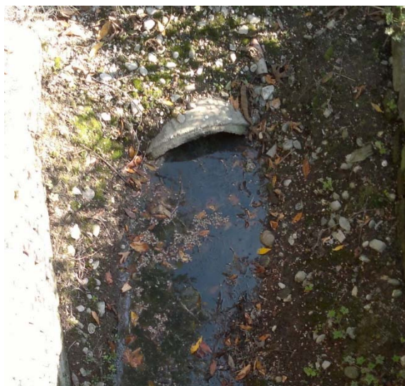
Figura 29. Inizio tombinamento a valle della ferrovia
