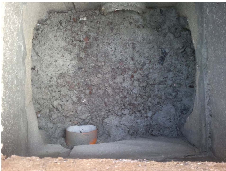
Figura 24. Stato della condotta lungo via Ca' Rubaldi (linea "6")
