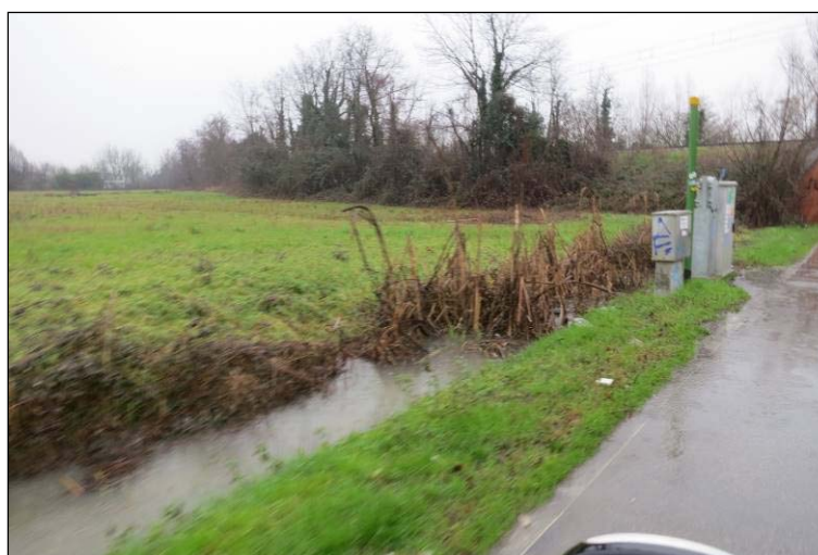
Figura 94. Affossatura di guardia posta a Ovest della ferrovia durante un evento meteorico
