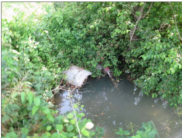
Figura 90. Tratto iniziale del tratto necessario di manutenzione
