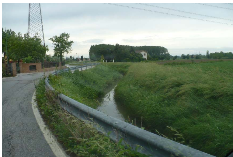
Figura 59. Scolo Comuna a monte del sifone sotto il Canale Taglio di Mirano
