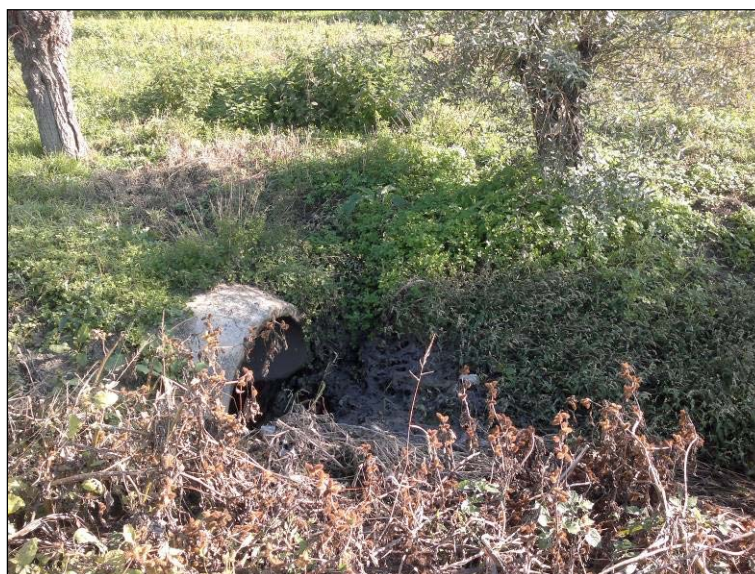
Figura 71. Punto di recapito sfioratore di piena
