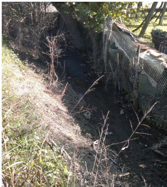
Figura 31. Stato manutenzione fosso a monte della ferrovia
